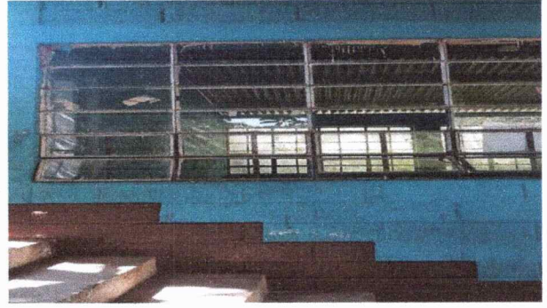
Foto 4: VIDRIOS Y VENTANALES EN DETERIORADOS
