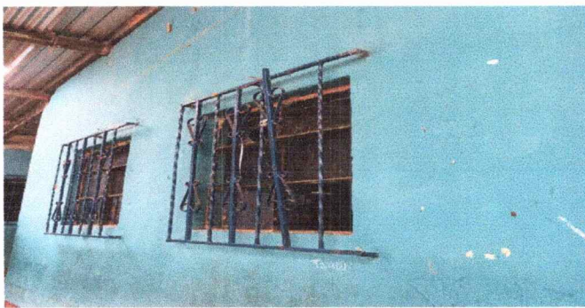
Foto 3: BALCONES EN MAL ESTADO
